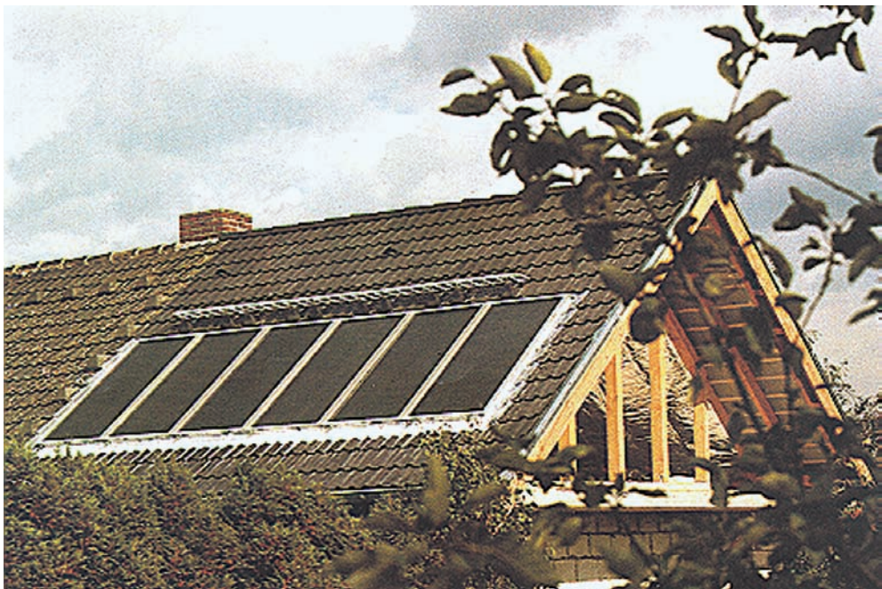
Abb. 2 Solare Kollektoranlage zur Erwärmung von Warmwasser. Eine Kollektoranlage zur Warmwassererwärmung ersetzt jährlich bis zu 400 l bzw. 400 m 3 an Heizöl oder Erdgas. Sie spart des weiteren 100 bzw. 600 kg jährlich Kohlendioxid ein. Ihre Herstellung und Montage verursacht dagegen einen Energieverbrauch entsprechend 360 l Heizöl und einen Kohlendioxidausstoß bis zu 700 kg.
